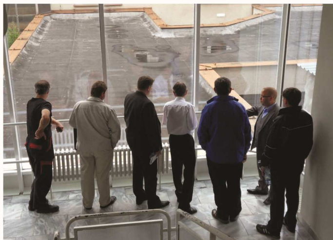
Zastupitelé byli na poliklinice seznámeni i s technickým stavem bufetu a stavem střechy nad krčkem.
